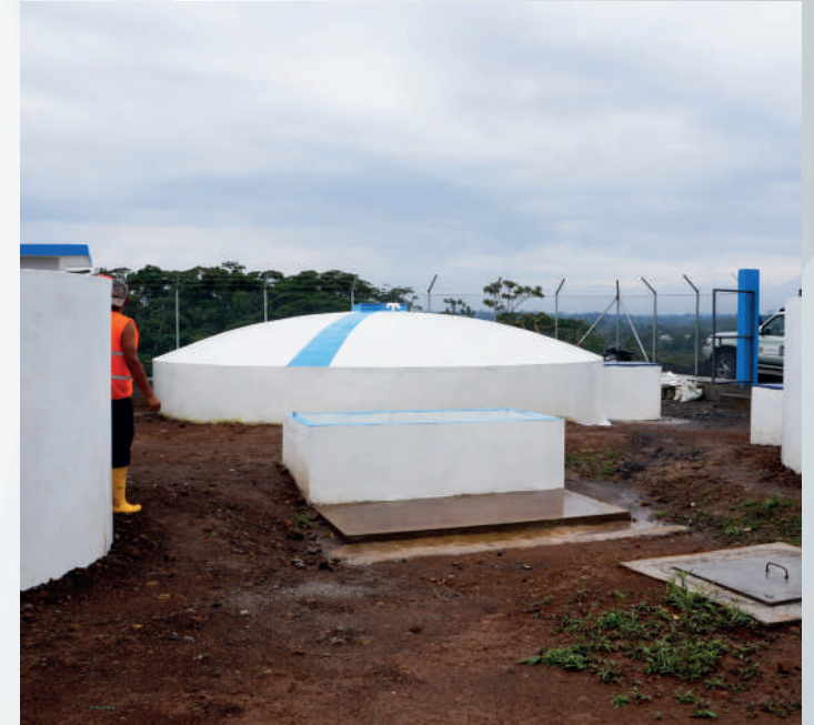
Construcción y fiscalización del Sistema de Agua para San Pedro y Purísima
