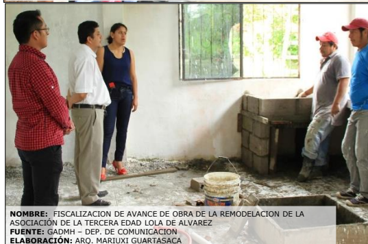
NOMBRE: REMODELACION DEL EDIFICIO DE LA ASOCIACION DE LA TERCERA EDAD LOLA DE ALVAREZ FUENTE: GADMH - DEP. DE COMUNICACION ELABORACION: ARQ. MARIUXI GUARTASACA
